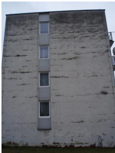
extrémně znečištěná fasáda; v tomto případě byla údržba ETICS trestuhodně zanedbána
